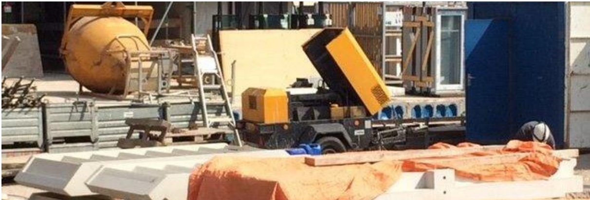
Afbeelding 1.3 - Een dieselaggregaat op een bouwplaats.
